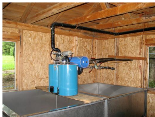
Cabanon de pompage : cuve en inox pour recueillir l'eau d'érable.
